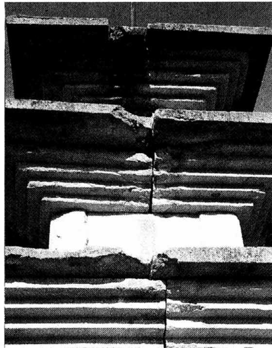
◊탑상층부 중앙에 박혀 있는 활주와 탑신의 중심선이 일치하지 않는 등 감은사지 서탑의 옥개석이 육안으로 보기에도 뚜렷이 어긋나 있어 정밀진단과 보수가 시급하다.
