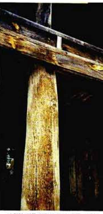
◊경북 안동 봉정사 누각, 앞쪽 기둥이 산탄총을 맞은듯 수많은 작은 구멍이 나있다. 흰개미가 파먹은 흔적이다.
