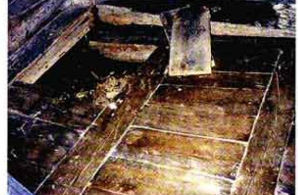
◊전북 김제 귀신사 대적광전(보물 제826호), 거의 모든 기둥이 흰개미 피해를 입어 마루바닥의 널빤지가 떨어져 나가고 기울어졌다.
