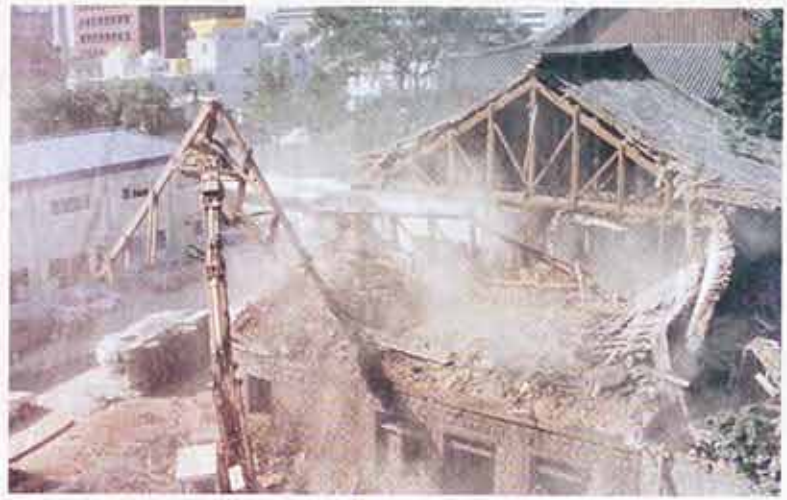
철리는 '정화 40년' 지난 57년 8월 불교정화를 기념하기 위해 조계사 경내에 세워진 정화회관이 지난 5일 철렸다. 조계사는 이 자리에 지하 2층 지상 5층의 법당인 '통일기원 민본보전'을 신축한다. (사진=고영배 기자)
