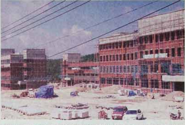
경북 경주군 강동면 유곡리에 위치한 진각종립 위덕대학은 내년 3월 개교를 앞두고 마무리 공사가 한창이다.
